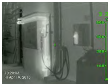
Conduite de chauffage
